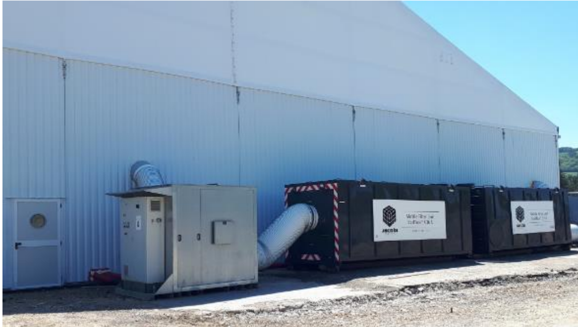
Unité de traitement de l'air d'une tente conventionnelle
